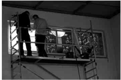
Arbeiter der Firma Saile setzen die Fenster ein, Foto: Dipl.-Ing. Peter Köhle
