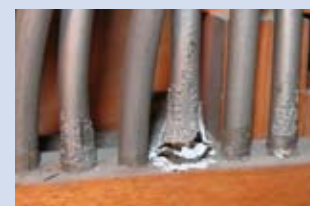
Im Laufe von fast 100 Jahren waren die Bleirohre der Pneumatik von Korrosion zerfressen.
